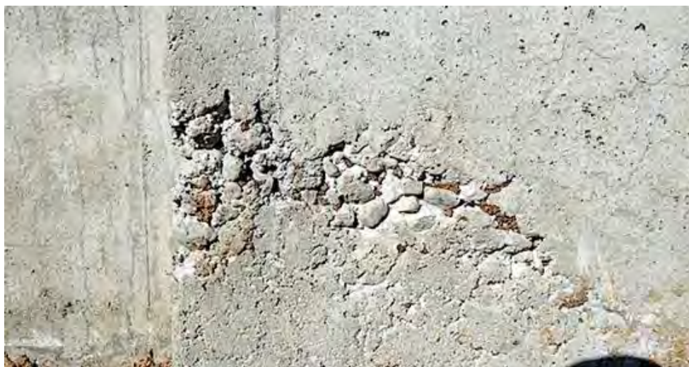
Рисунок 1 – Дефект в монолитной конструкции в результате отсутствия уплотнения бетонной смеси
