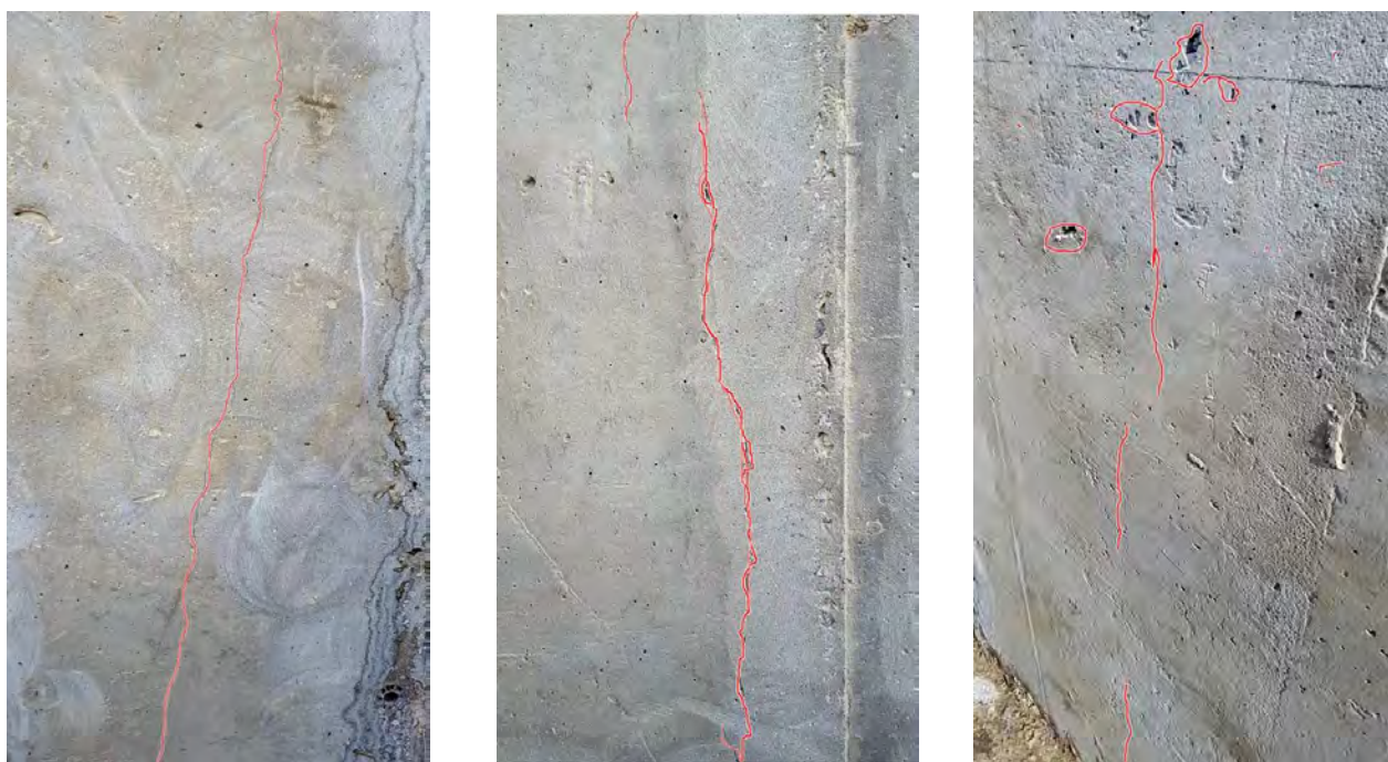
Рисунок 1-3 – Общий вид вертикальных трещин и дефектов по поверхности фундаментов
