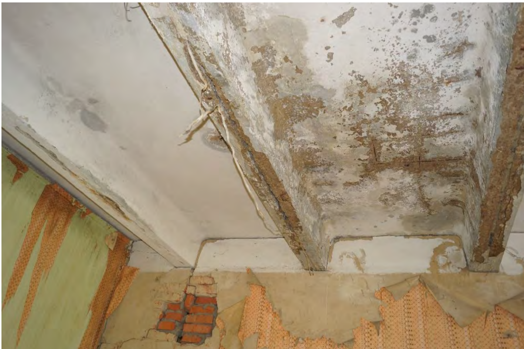
Рисунок 3 – Пример материалов фотофиксации дефектов конструкций здания
