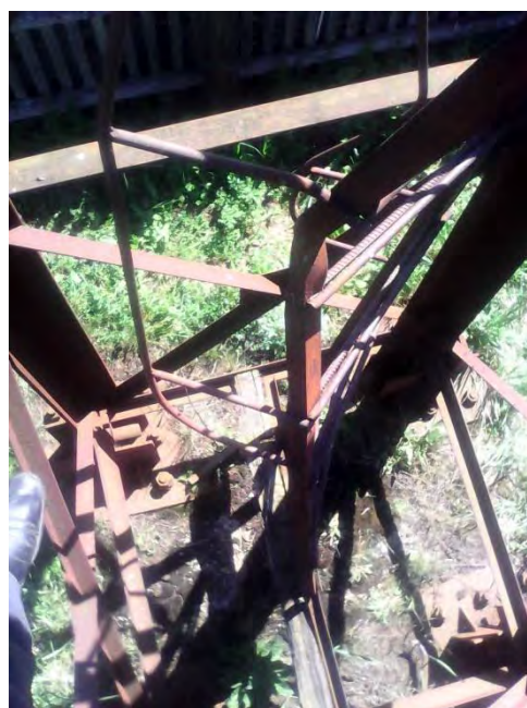
Рисунок 6 – Деформация и потеря устойчивости конструкций лестницы
