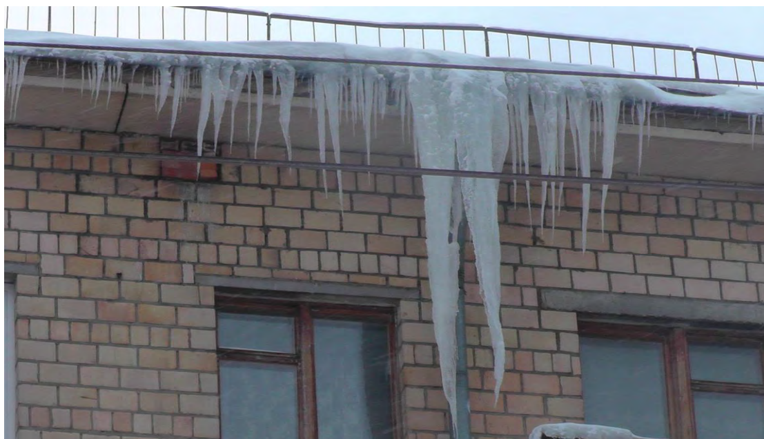
Рисунок 1 – Пример обледенения кровли
