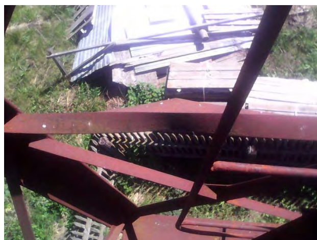
Рисунок 4 – Щелевая коррозия в местах сопряжения
