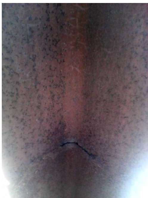
Рисунок 5 – Нарушение целостности сечения несущих стоек
